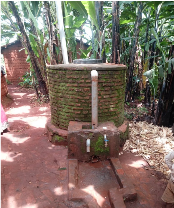
Collecteur d'eau de pluie avec des fissures
