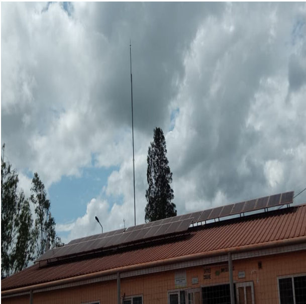
PHOTO DES PANNEAUX SOLAIRES
