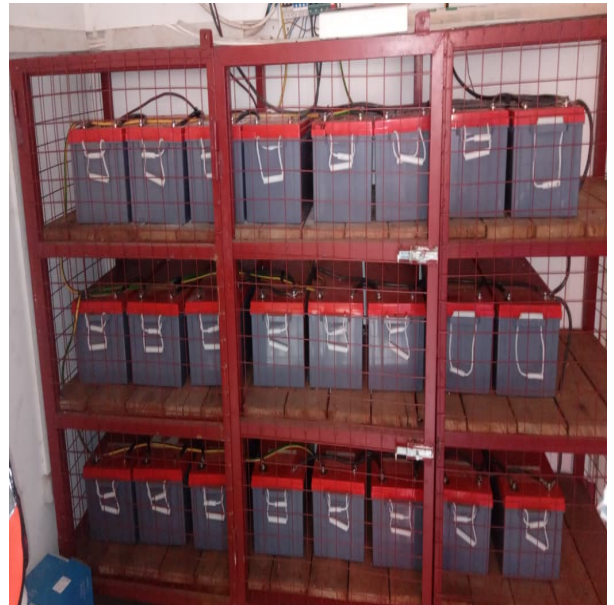
PHOTO PARC DE BATTERIES
