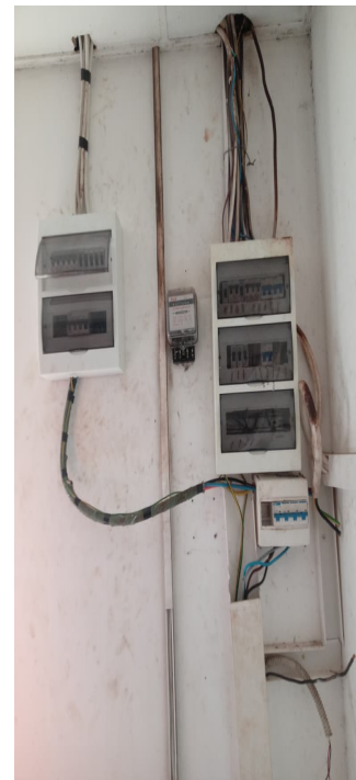
PHOTO COFFRET DES PROTECTIONS
